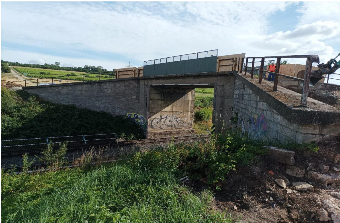
Abb. 2: Das marode und heutigen Sicherheitsaspekten nicht mehr genügende Altbauwerk kurz vor dem Abbruch
