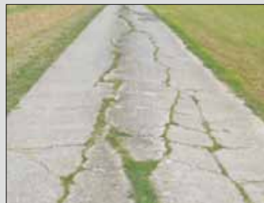
Abb. 2: Durch Überbelastung und fehlende Tragfähigkeit zerstörte Wegestruktur
