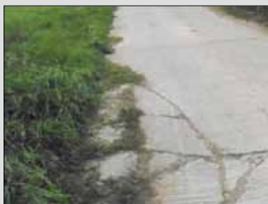
Abb. 1: Schäden in Folge fehlender Bankette und zu geringer Wegebreite
