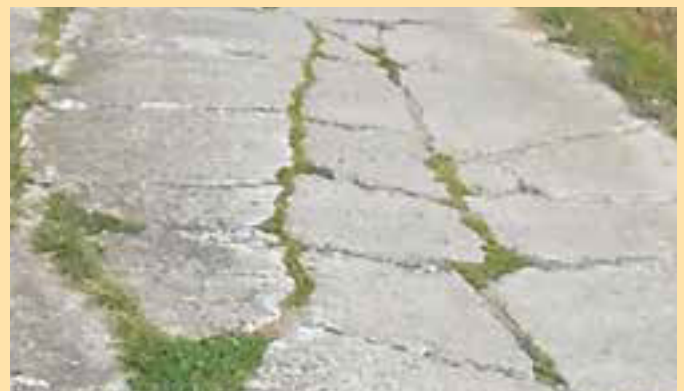
Abb. 2: Durch Überbelastung und fehlende Tragfähigkeit zerstörte Wegestruktur
