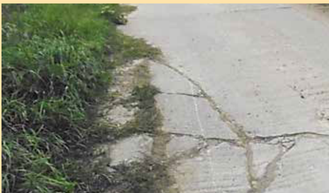
Abb. 1: Schäden in Folge fehlender Bankette und zu geringer Wegebreite
