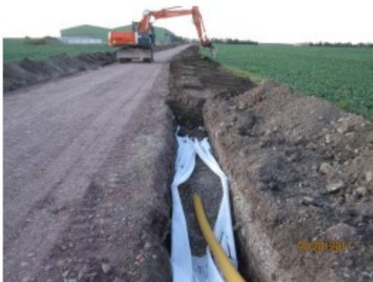
Drainsammler DN 100 beidseitig des Weges
